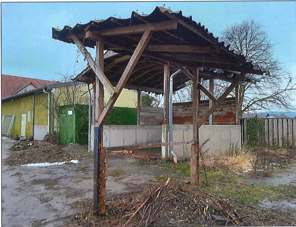
Foto 5: Gebäuderudiment von der vormaligen Pferdehaltung, dahinter die ebenfalls zum Abriss vorgesehene Lagerhalle (vgl. Foto 1, rechte Seite) / 14.01.2026
